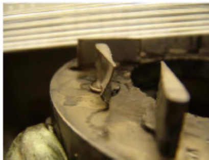
Beschädigte Düsen der Laufschaufeln
