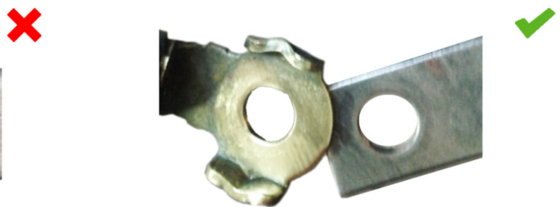
Fig. 2: Jordforbindelse etter rengjøringen: Kontakt god
