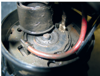
二次空气泵驱动电机内的腐蚀性尾气冷凝物
